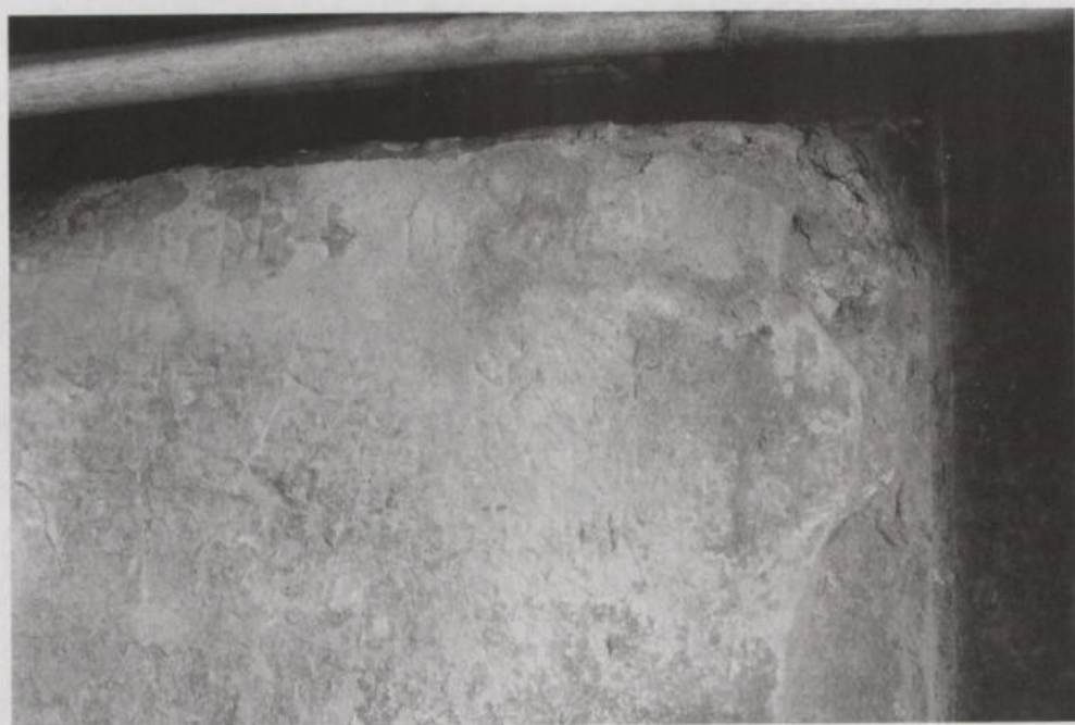
斗六福德宮【嚴禁藉差擄搶碑記】舊碑局部風化嚴重之情形
